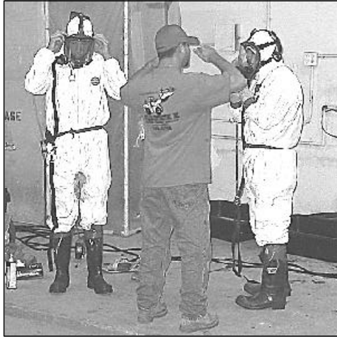
Trabajadores vestidos en trajes protectivos para materiales peligrosos y con respiradores se preparan para quitar la tierra y el concreto contaminado del interior de la instalación clausurada de Master Plating.
